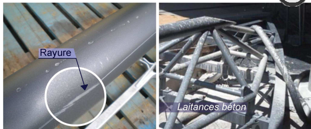
PHOTOS 31 ET 32: RAYURES ET POLLUTIONS SUR CHANTIER
